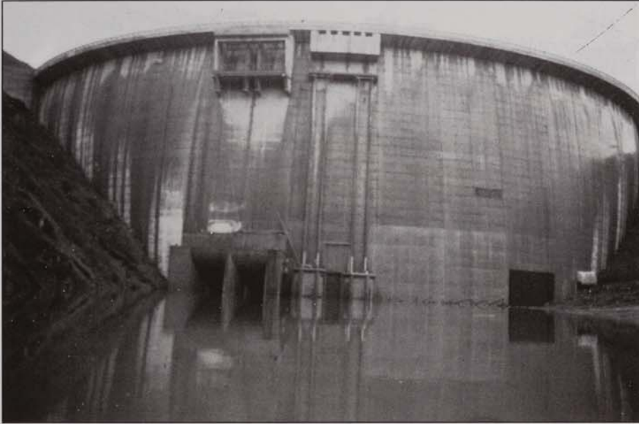
Photo 3: Parement amont: zone fissurée.
