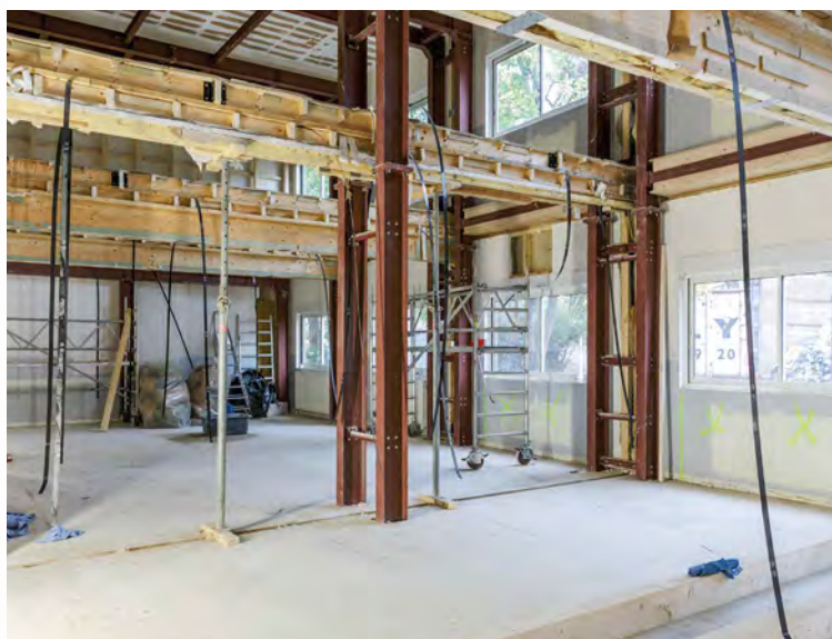
Démolition du plancher et des anciens murs en bois dans la future salle de lecture à double hauteur.
