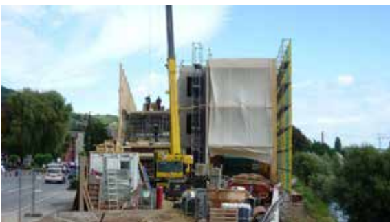
„Rohbau im Bereich des westlichen Fluchttreppenhauses während der Montage“ © Daedalus Engineering S. à r. l.
