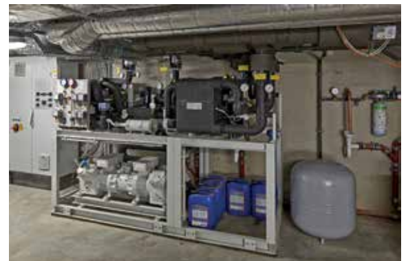
_Wasser-Wasser-Wärmepumpe der Naturverwaltung Diekirch
