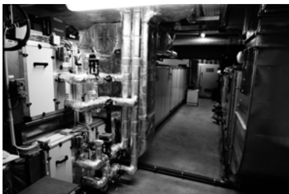
_Raumlufttechnische Anlage der Naturverwaltung Diekirch
