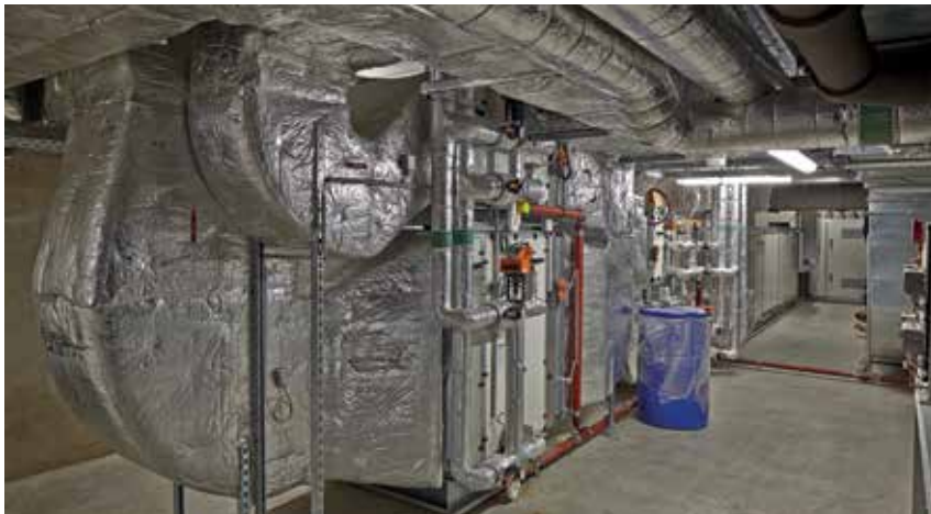
_Technikzentrale im Untergeschoss
