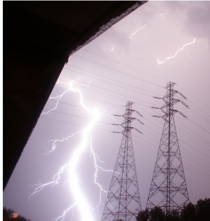
Freileitungsmasten mit Erdseilen bei einem Gewitter
