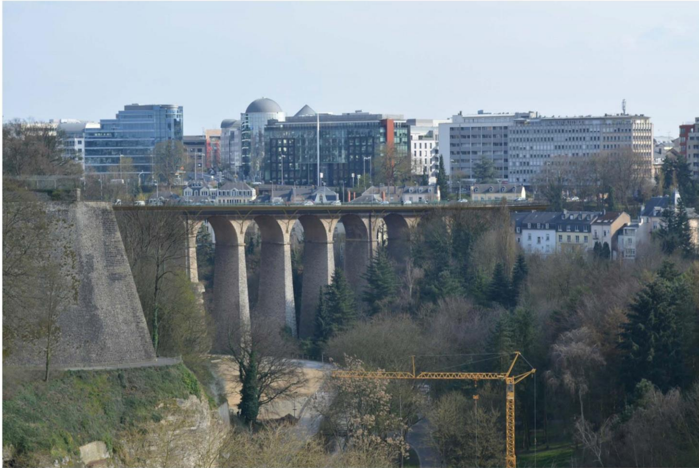
Image 5 : Elévation amont de l'ouvrage - Depuis côté amont versant gauche - vers côté gare
