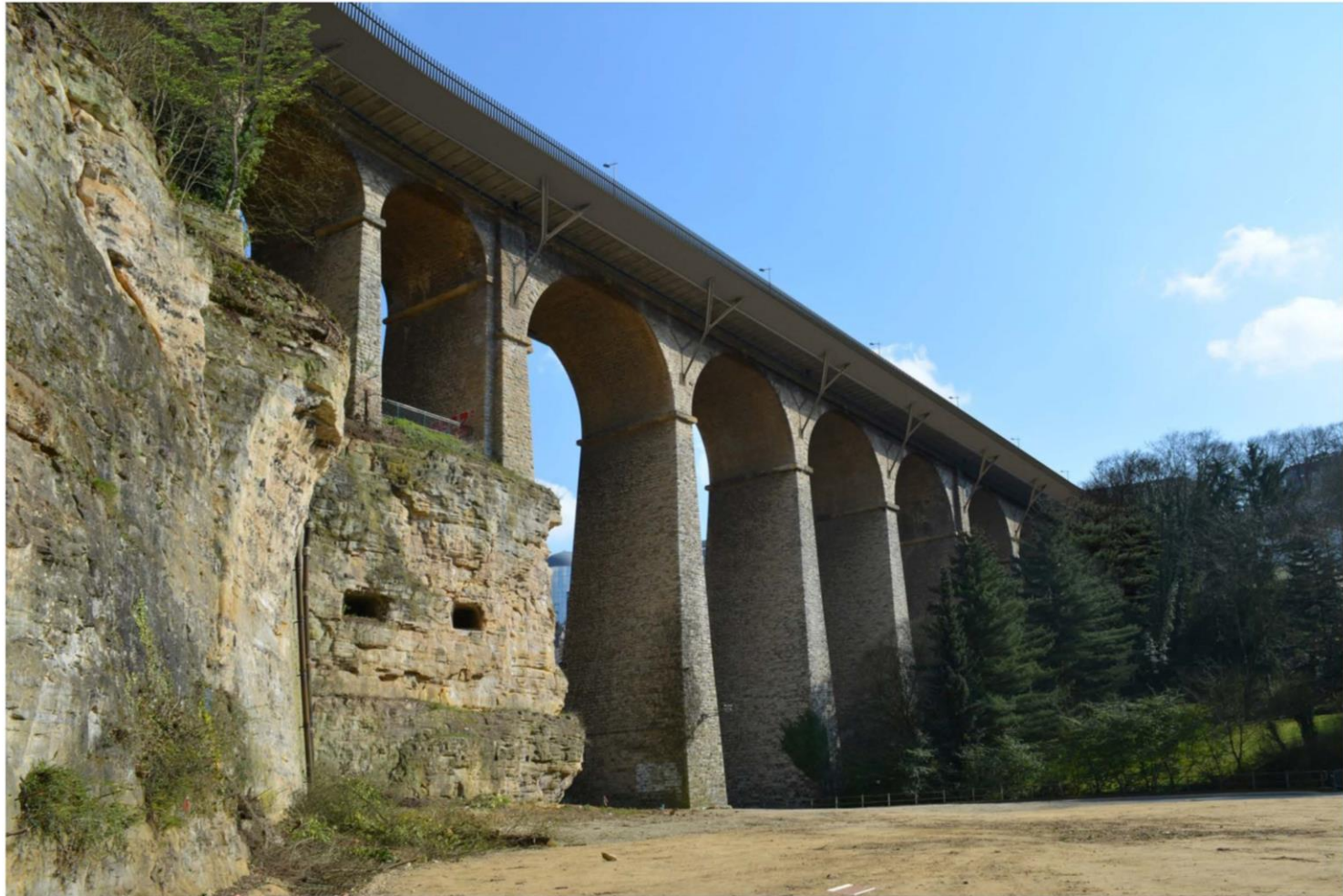
Image 4 : Elévation amont de l'ouvrage : Depuis côté amont rive gauche - vers côté gare
